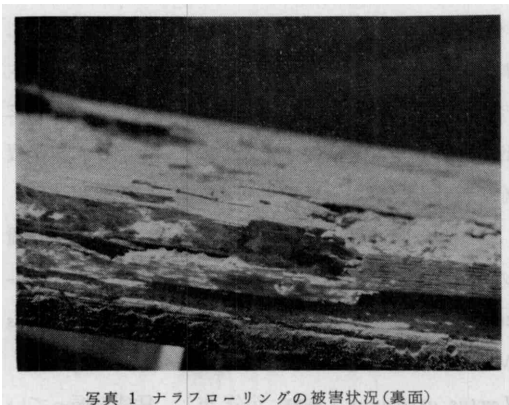
写真 1 ナラフローリングの被害状況(裏面)
